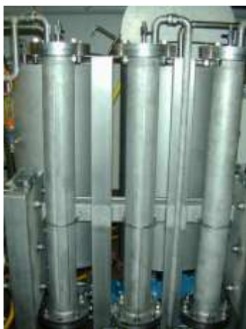
Colonnes de filtrations (nano et ultrafiltration) pour le désucrage du moût (matériel Bucher-Vaslin).
